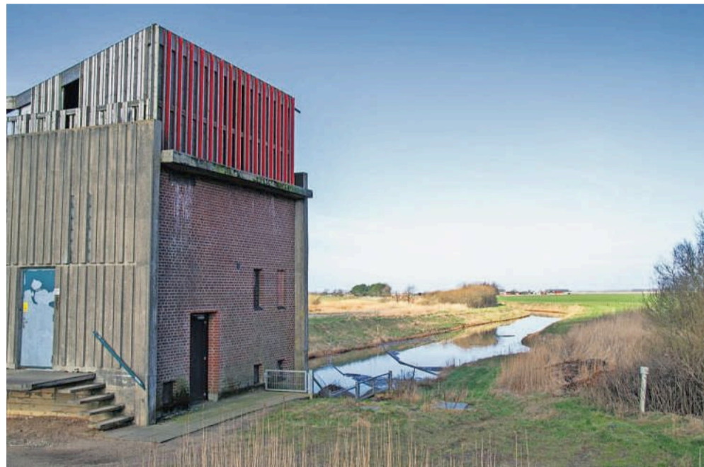
Pumpestation Nord er faktisk stadig i drift, for den afvander et stykke landbrugsjord, som ikke blev en del af naturgenopretningsprojektet omkring årtusindeskiftet.
